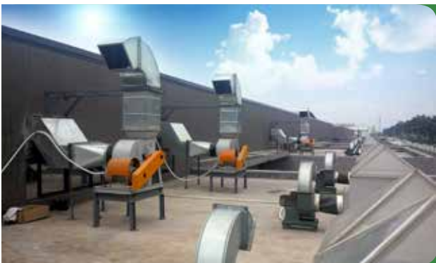
Hệ thống thông gió
