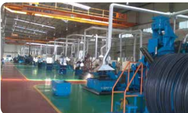
Hệ thống hút khói dầu
