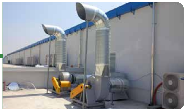
Hệ thống thông gió
