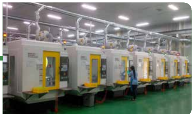
Hệ thống hút hơi dầu
